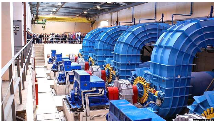
Рис. 5.47. Обладнання компанії ІНСЕТ на МГЕС Ляскеля в Карелії, http://www.sdelanounas.ru/blogs/20974
