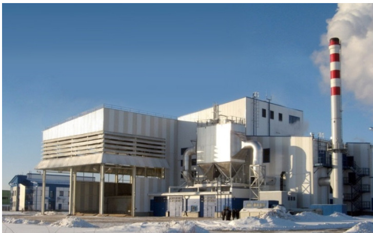
Рис. 6.43. Міні ТЕС на біомасі в м. Пручани (Беларусь), N=3,7 МВт, (2009 р.) URL: http://www.energsovet.ru/bul_stat.php?idd=492
