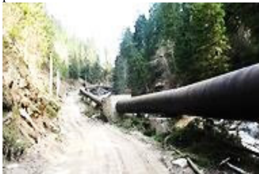
Рис. 5.30. Напірний трубопровід малої ГЕС дериваційного типу;
