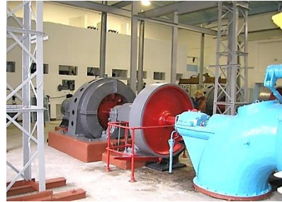
Рис. 5.26. Машинна зала ГЕС «Біле вугілля» на річці Підкумок
