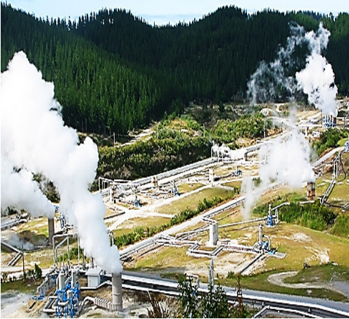
Рис. 3.7. Найбільша в світі геотермальна станція потужністю 750 МВт. Мексика
