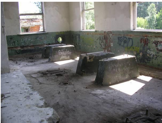
Рис.9.10. Машинна зала Велико-Сорочинської малої гідроелектростанції, с. Кам'яний Брід (340 кВт)
